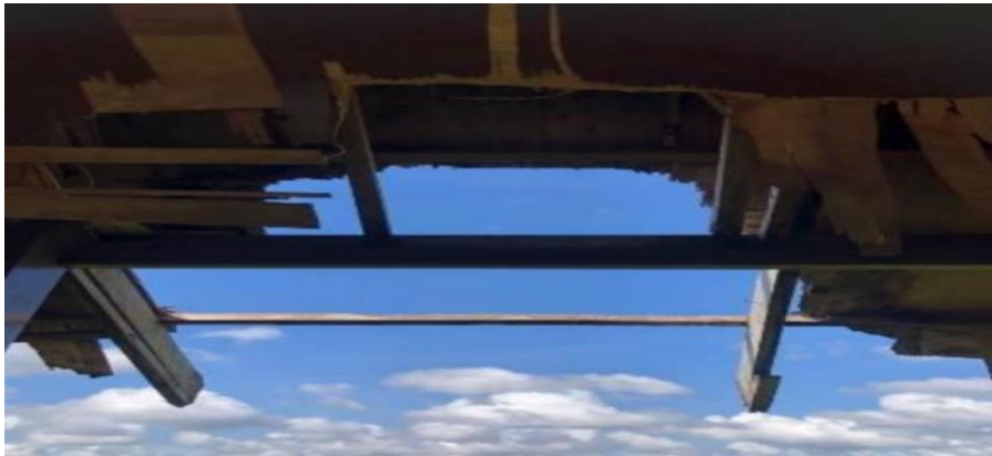
Foto 11: Keadaan Atap di Bukit Tengkorak yang rosak
