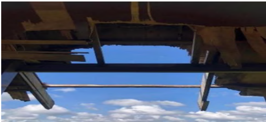
Foto 11: Keadaan Atap di Bukit Tengkorak yang rosak
