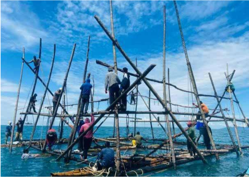
RAJAH 1 Pembinaan bagang di Kampung Indera Sabah oleh para nelayan. Sumber: Diberikan oleh salah seorang nelayan di Kampung Indera Sabah yang menunjukkan aktiviti pembinaan bagang di tengah-tengah laut di Kampung Indera Sabah.
